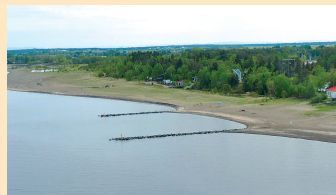
SUR LA PHOTO : Ces épis construits en 2014, dans le secteur du Camping du club social de l'Usine Alma, ont pour objectif de stabiliser les berges allant du Camping Saint-Pierre jusqu'à la Belle Rivière, soit tout un secteur d'environ 1,2 km.
